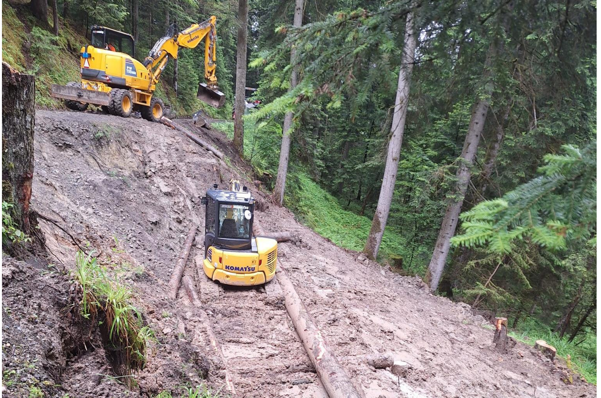
Abb. 7: Verbau von Rutschung der Forststrasse im Neuenbaan mit Holzkasten.
